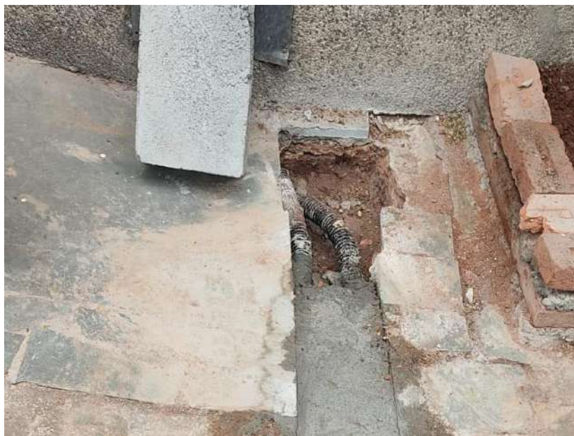
Duto corrugado em PEAD
