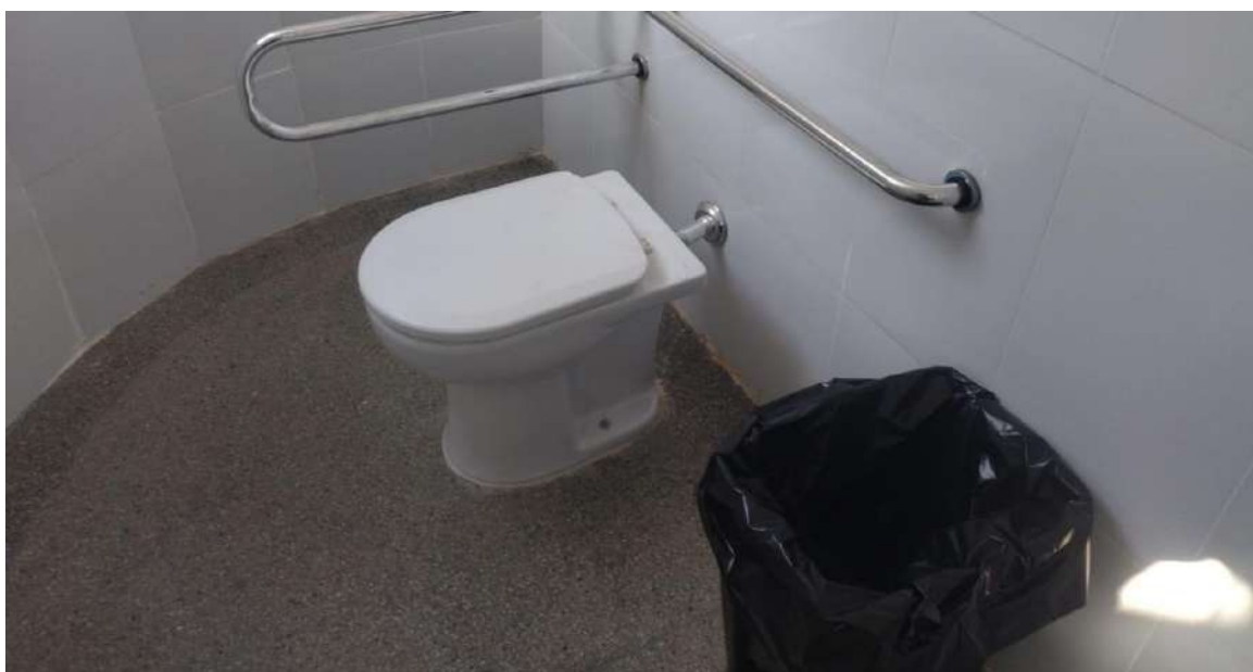
Vaso sanitário para PCD instalado
