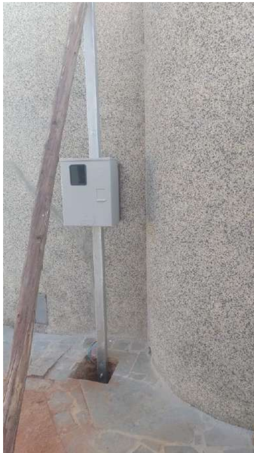
Instalação do padrão de energia da CEMIG
