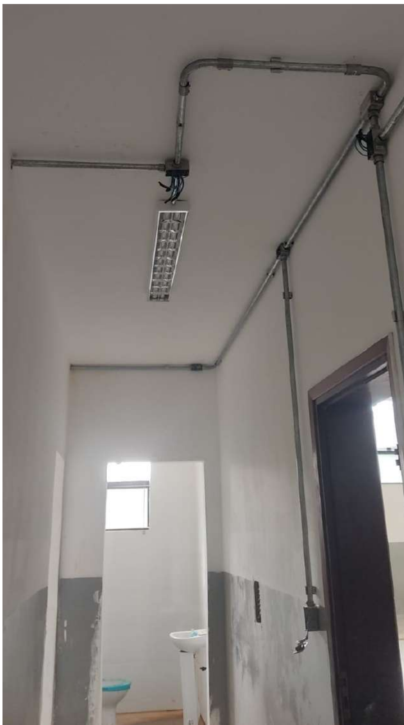
Iluminação do corredor
