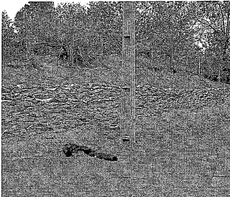
Figura 03 – Imagem do poste instalado e do dreno rompido e removido
